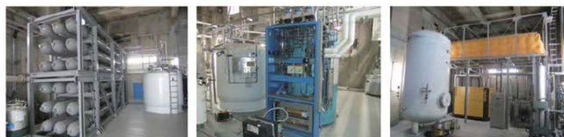
長尺容器(左)、液体ヘリウム貯蔵容器(右) 液体ヘリウム貯蔵容器(左)、ヘリウム液化機(右) ガスバッグ(上)、ヘリウム圧縮機(下)、ヘリウムバックアップタンク(左)
